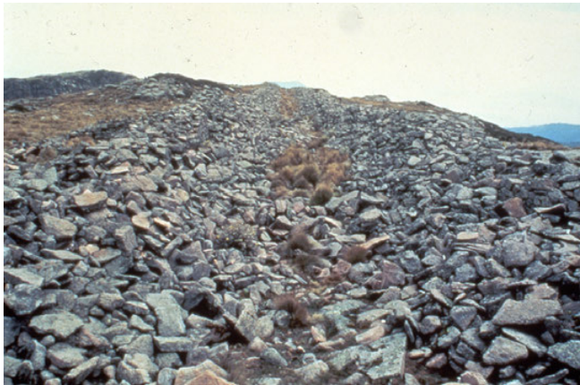
Figura 14 - El Santuario del Cerro Tláloc antes de su intervención reciente: los muros caídos de la calzada de acceso dirección oeste-este (foto J. Broda, octubre 1984).
